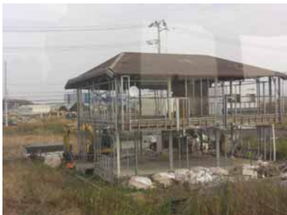
骨組みだけが残った家屋
